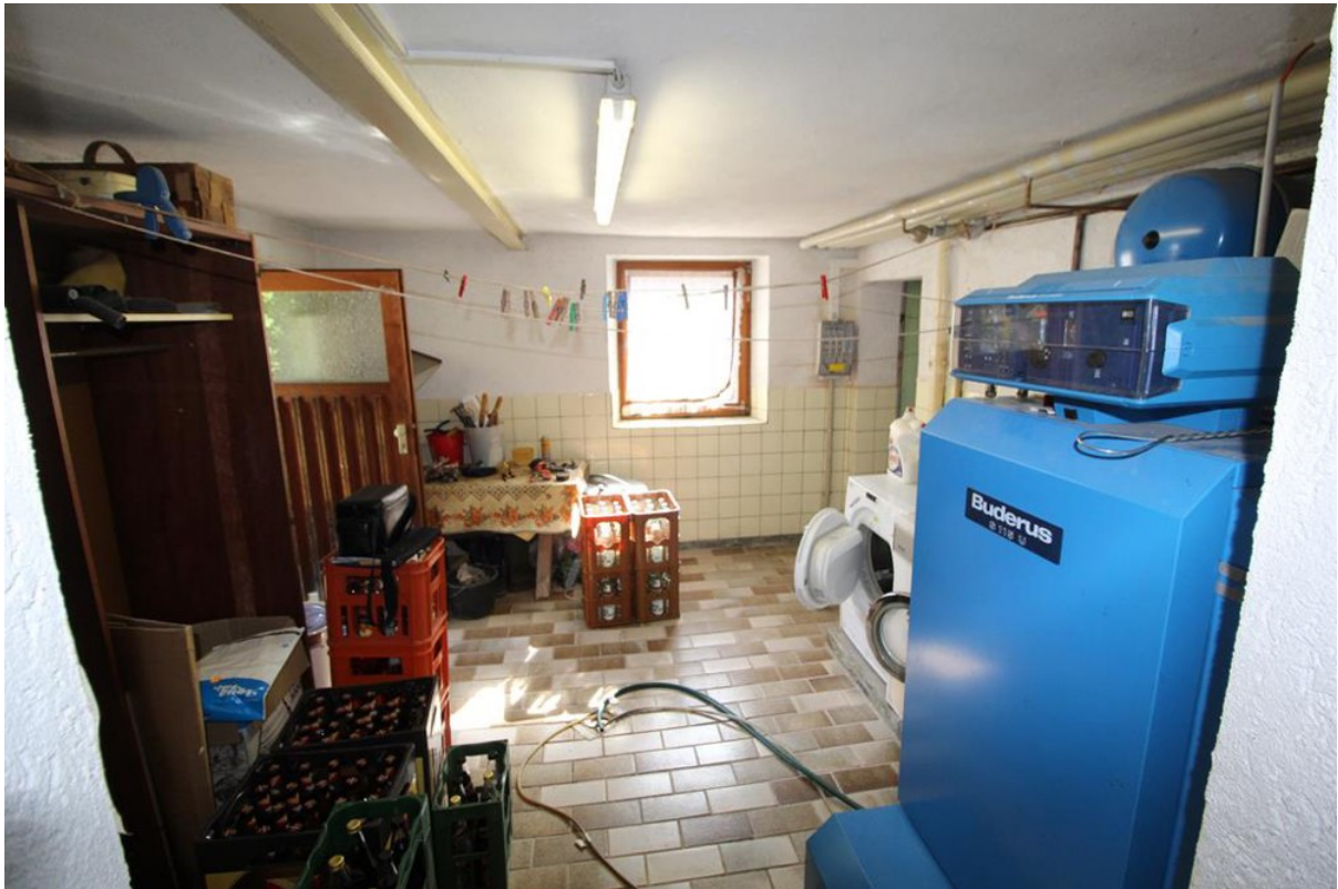
UG Heizraum Waschküche
