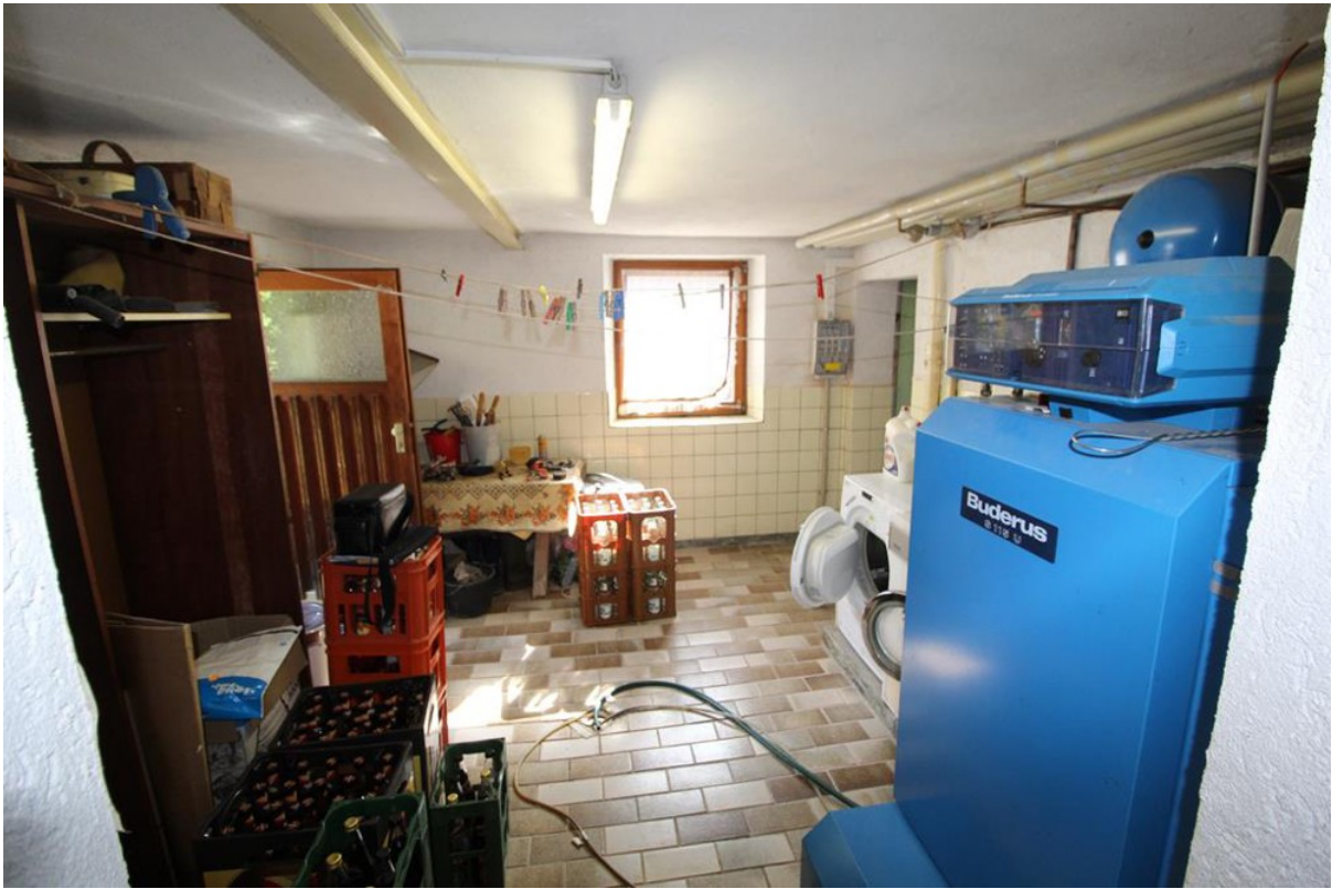
UG Heizraum Waschküche
