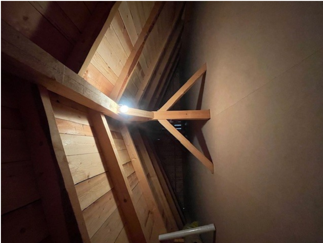
Speicher im Nebengebäude
