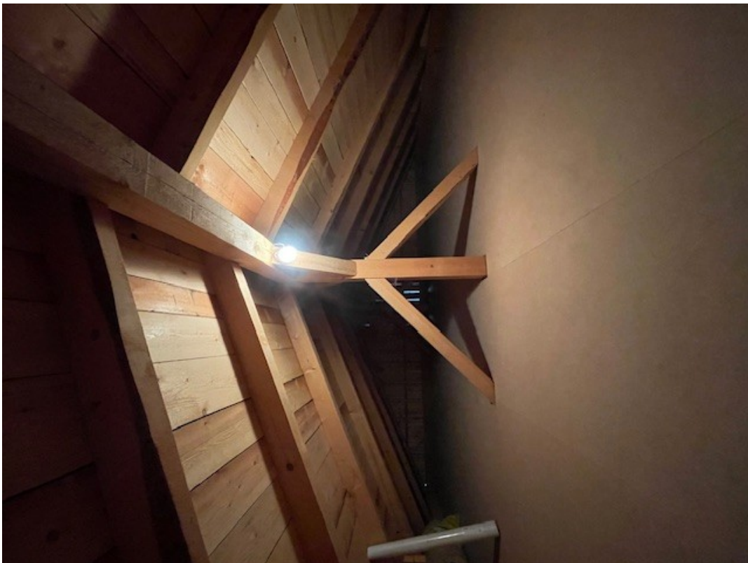
Speicher im Nebengebäude
