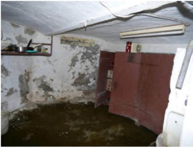
Bild 25 Kellergeschoss Blick in einen Kellerraum. Der Boden zeigt große Unebenheiten. Wände in Mauerwerk, grob verputzt und gestrichen. Der gesamte Kellerbereich zeigt sich modrig und durchfeuchtet.
