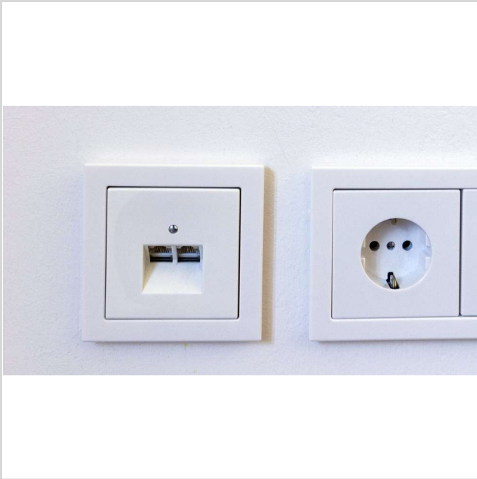
DV Telefon Verkabelung Cat7
