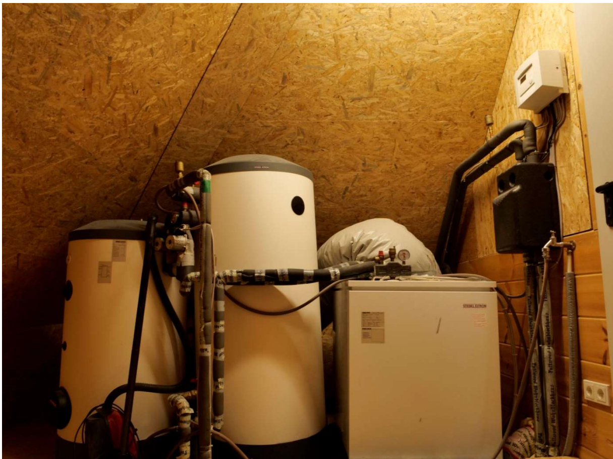
Wärmetauscher und Warmwasserspeicher
