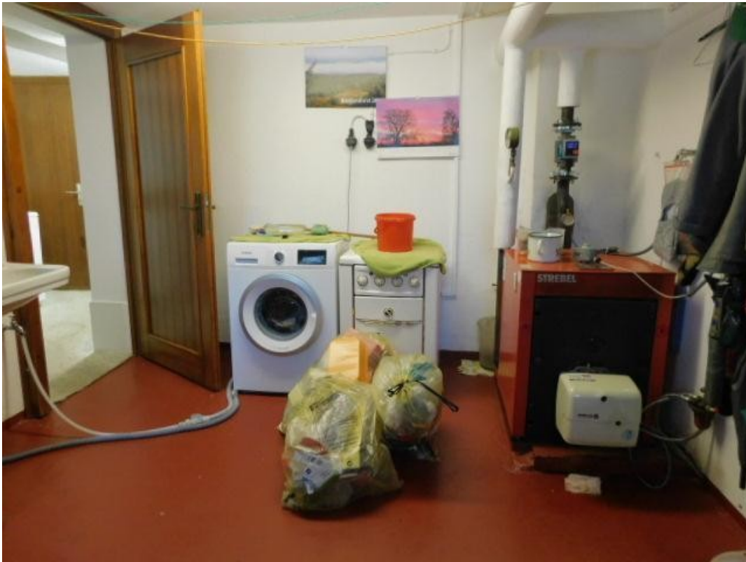
SB28 Wasch- und Heizungsraum
