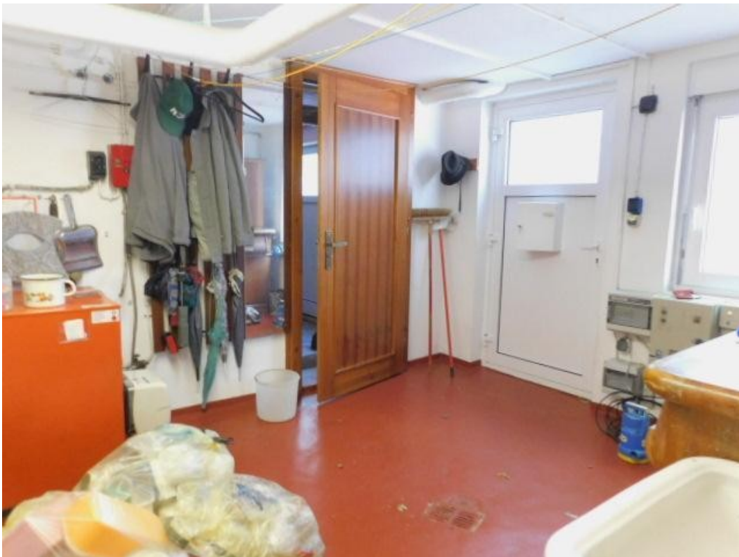
SB28-1 Wasch- und Heizungsraum
