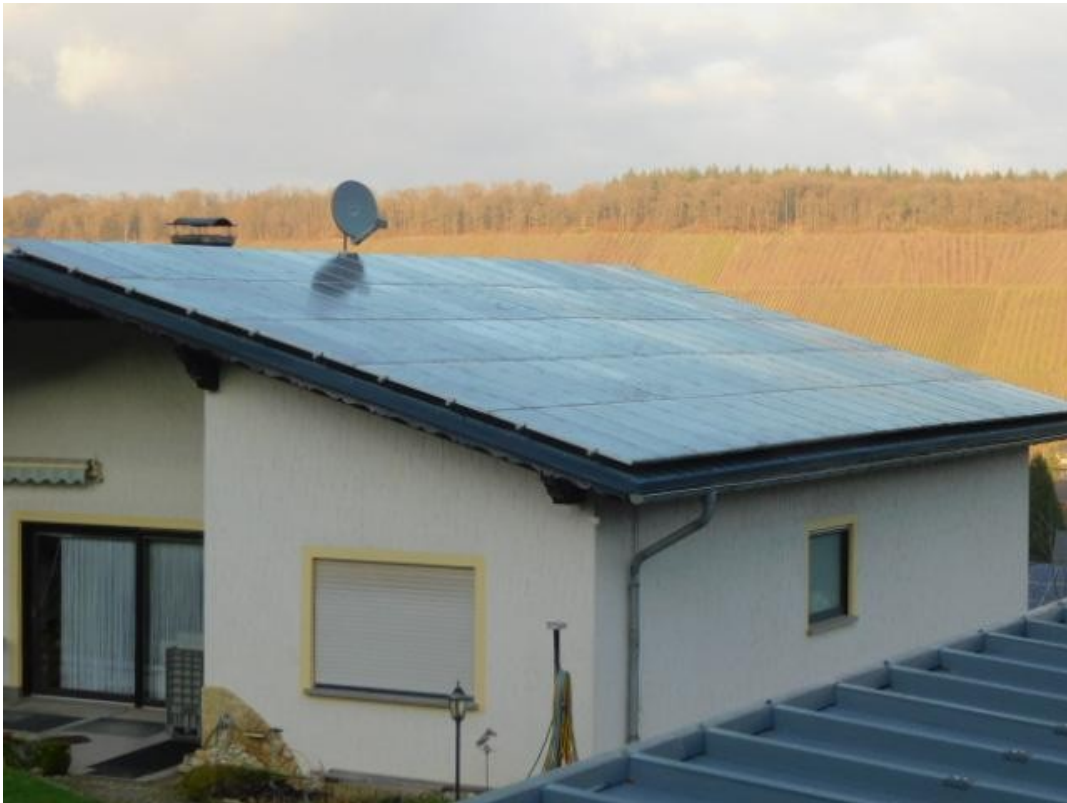
FB32 Hausdach mit PV Anlage
