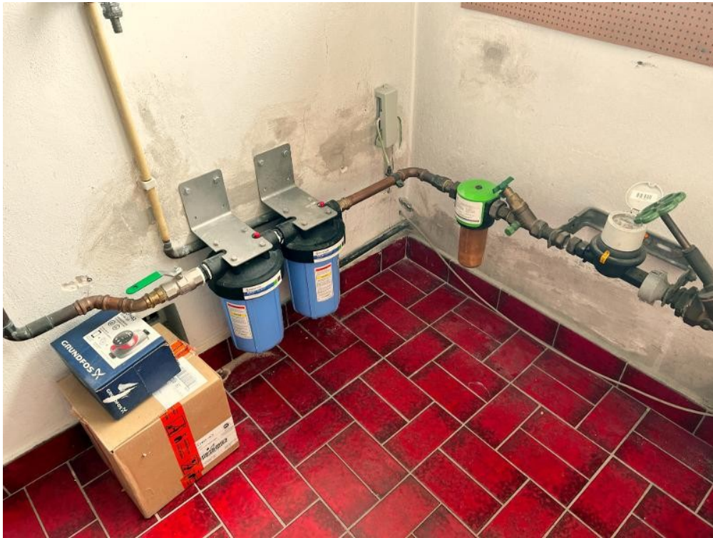
Frischwasserversorgung mit Fei
